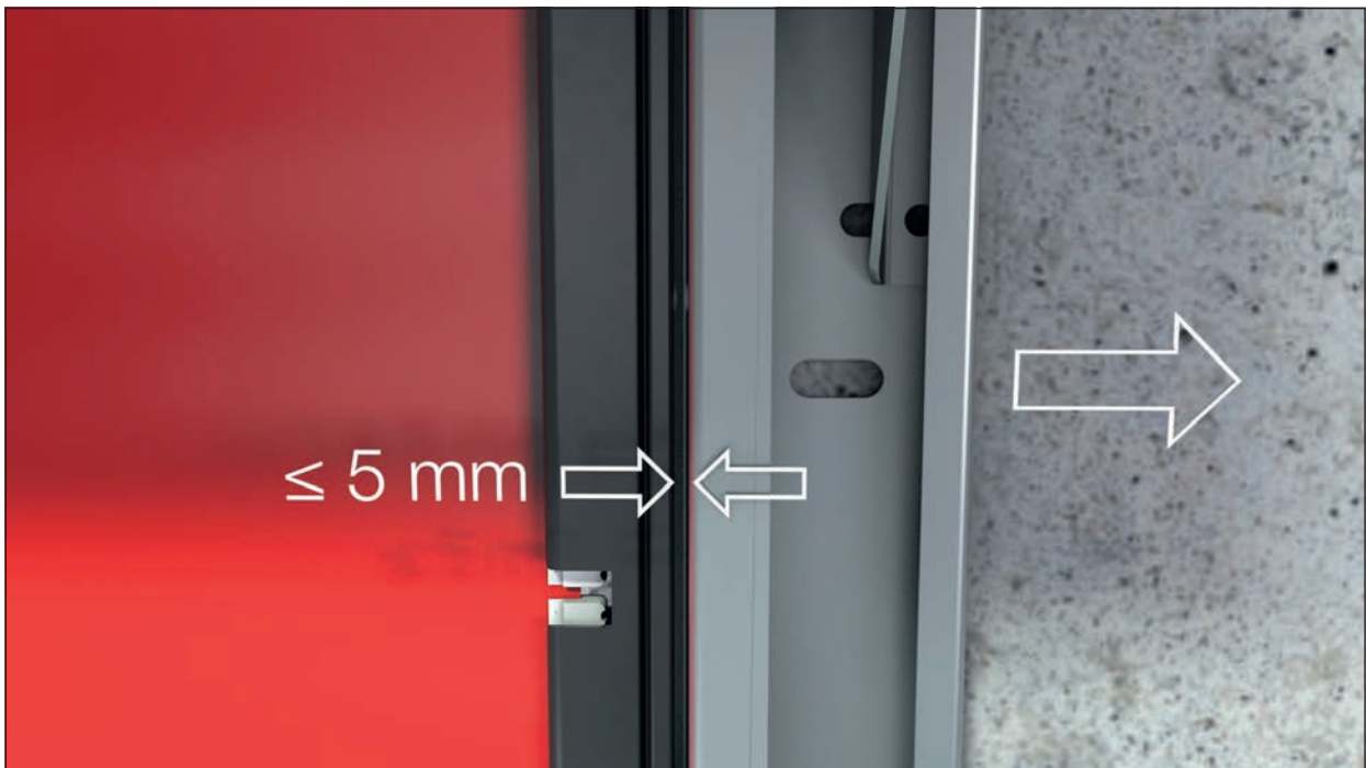
Bild 9 - Die Zargen werden auf ganzer Höhe auseinander gezogen und es werden < 5 \text{ mm} zwischen Zarge und Führungsschiene (U-Profil) angezeigt. Der Behang sollte glatt sein und keine Falten haben.
